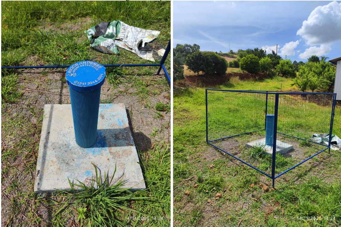
Figura 3: Poço artesiano do local
